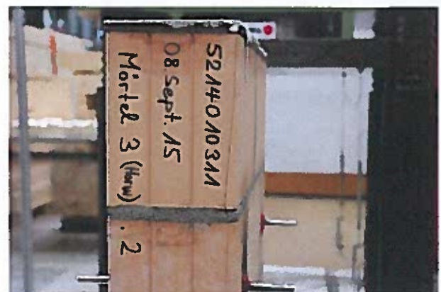
Abbildung 6: Mauerwerkskleinkörper Nr. 3.2 nach Versuch. Zwei sichtbare Risse an der Stirnseite (links und rechts).
