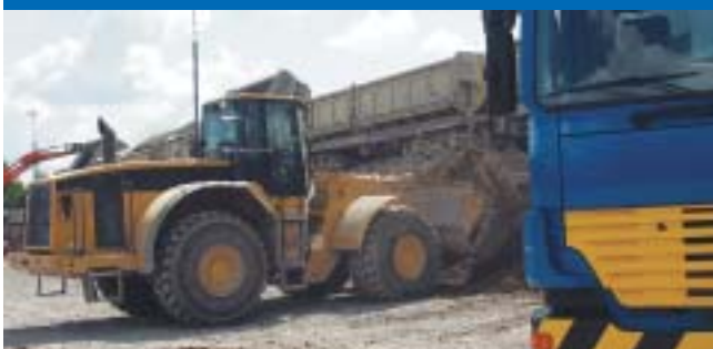
Ein elektrifiziertes Anschlussgleis ermöglicht eine umweltschonende Anlieferung grosser Mengen von Inertstoffen aus Grossbaustellen. Bis 1200 Tonnen Material können «in einem Zug» angenommen werden.
